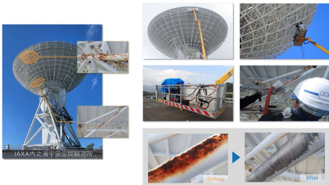
図 11 高所の足場が組めない構造物への施工例 (トヨコー殿提供)
